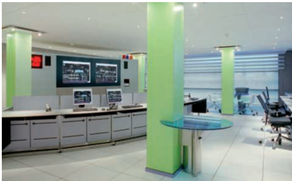
Poste de commande de l'usine des eaux de Choisy-le-Roi (SEDIF).
